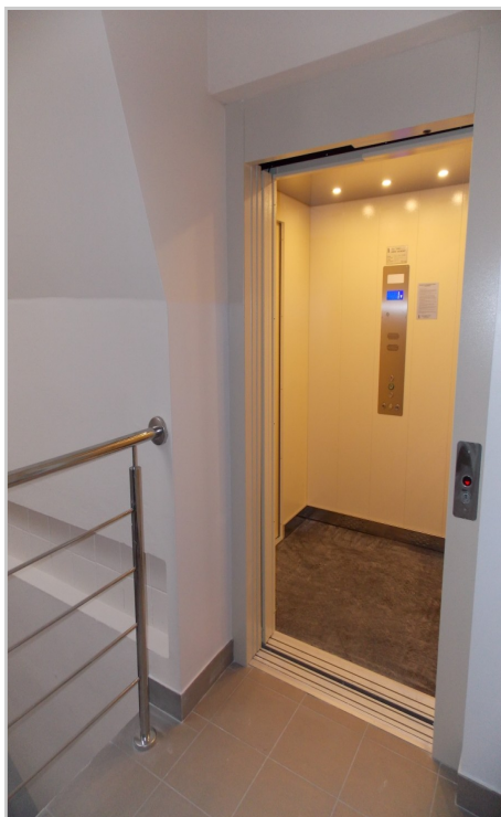
Winda umożliwia swobodne przemieszczanie się między kondygnacjami oraz korzystanie z zajęć w pracowniach usytuowanych na piętrze budynku.
